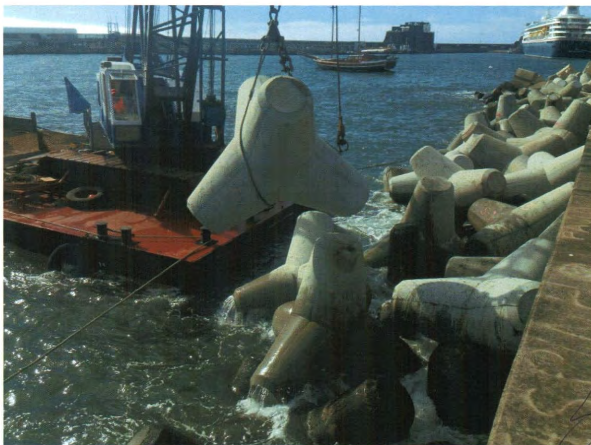
Trabalhos de reposição do manto de proteção do Molhe Sul da Marina do Funchal
